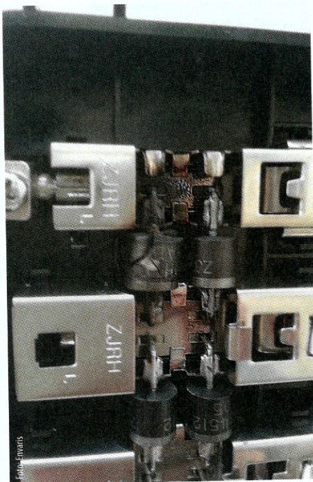
Hier hat der Blitz mindestens zwei Kontakte in der Dose zerstört.
